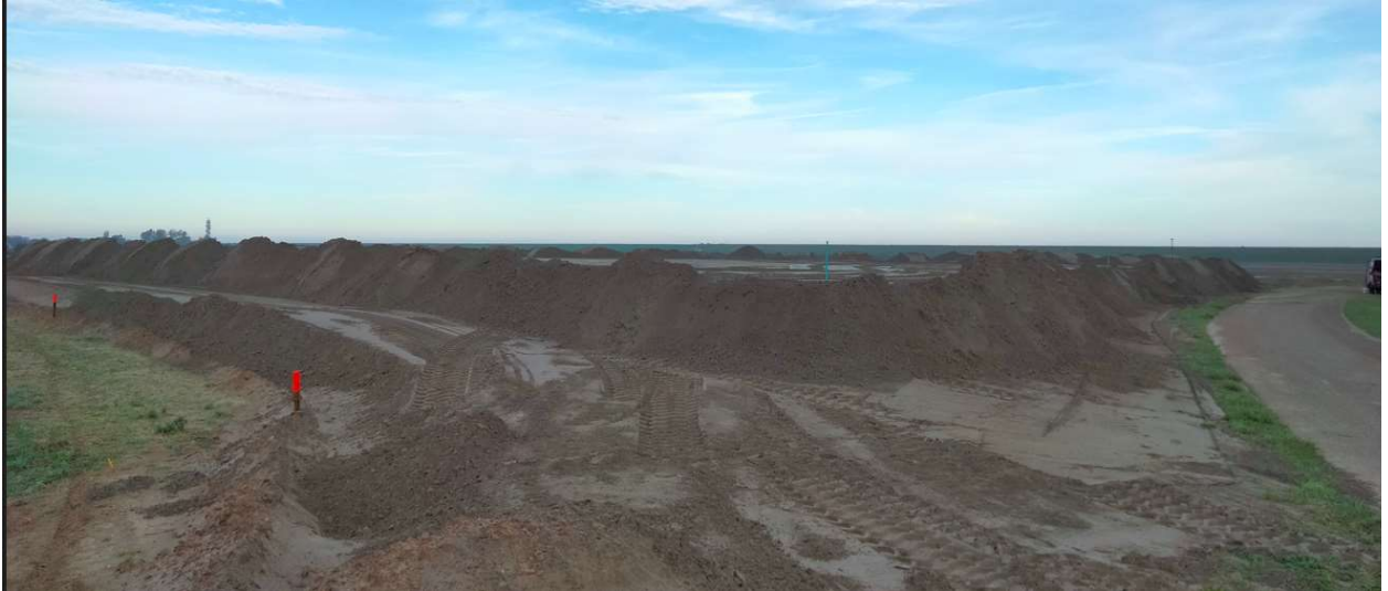
Foto 1 (voor fotorichting, zie tekening bijlage 2), zand aangevoerd op 27 oktober 2022 en aangebracht als tweede laag van 1 tot 2 m op maaiveld.
